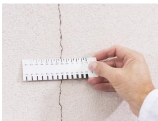
Slika 1. Provjera širine pukotine
