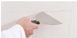
Slika 1. Detektiranje i otvaranje pukotina
